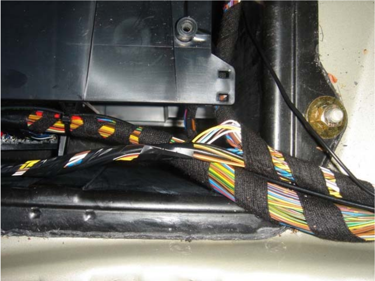
estos son los cables que hemos sacado de la manguera original y que hemos atado con cinta aislante y que van a quedarse al lado de la bm54:
